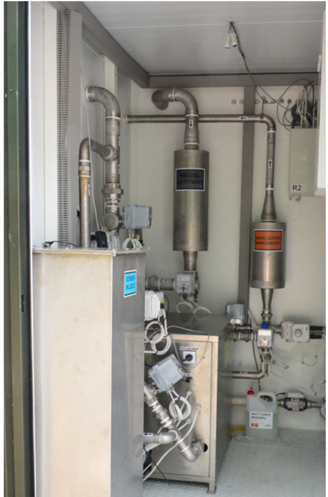
Rys. 2. Przedział aparaturowy z instalacją do generowania par nadtlenku wodoru.
